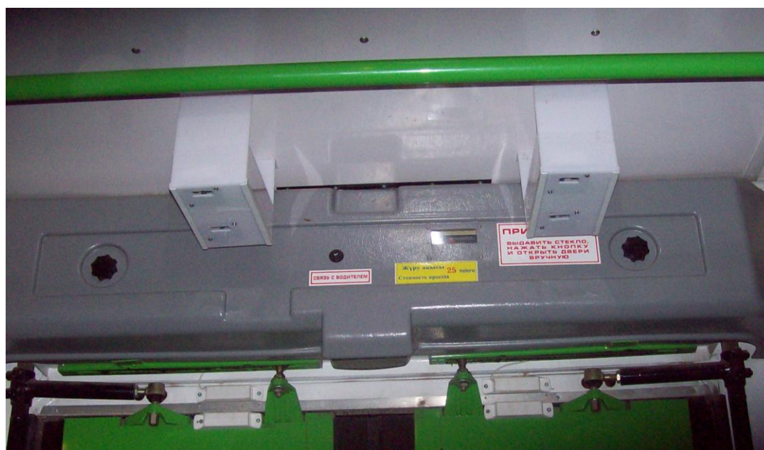
Рисунок 3.2 – Установка на двухстворчатую дверь автобуса ЛиАЗ ИК-датчиков «Луч-МС».
